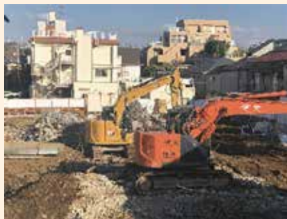
学園建物基礎部分がなくなった様子
